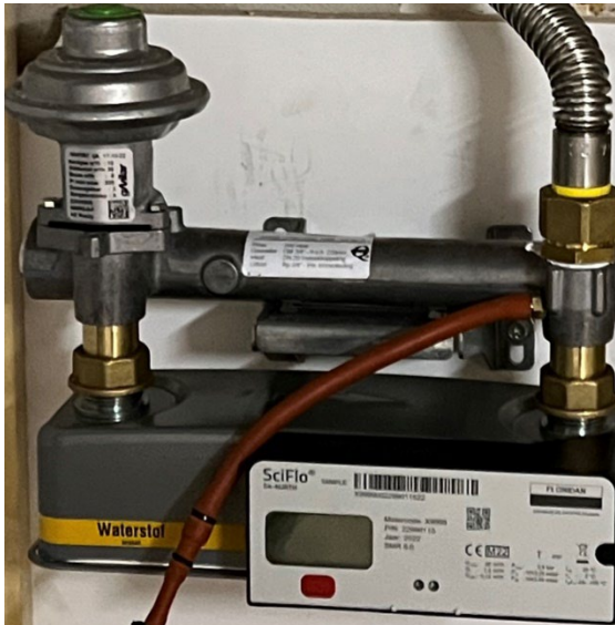
Flonidan waterstofgasmeter gemonteerd op de gasvoerende gasmeterbeugel. Duidelijk zichtbaar zijn de messingkoppelingen.
