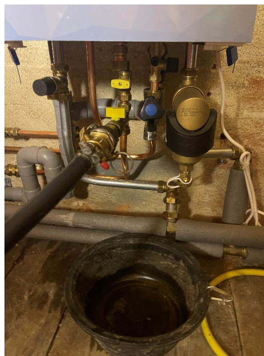
Spoelslang t.b.v. inertisering N 2 (en later spoelen met H 2 ) aangesloten op aansluitkraan verbrandingstoestel (de kraan staat op het moment van de foto dicht).
