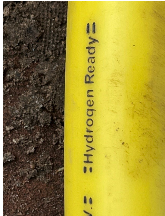
Detail foto PE aansluitleiding: Hydrogen Ready.
