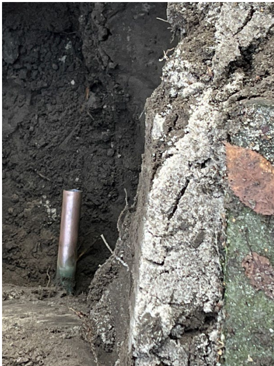
Bestaande (koperen) aansluitleiding richting woning.
