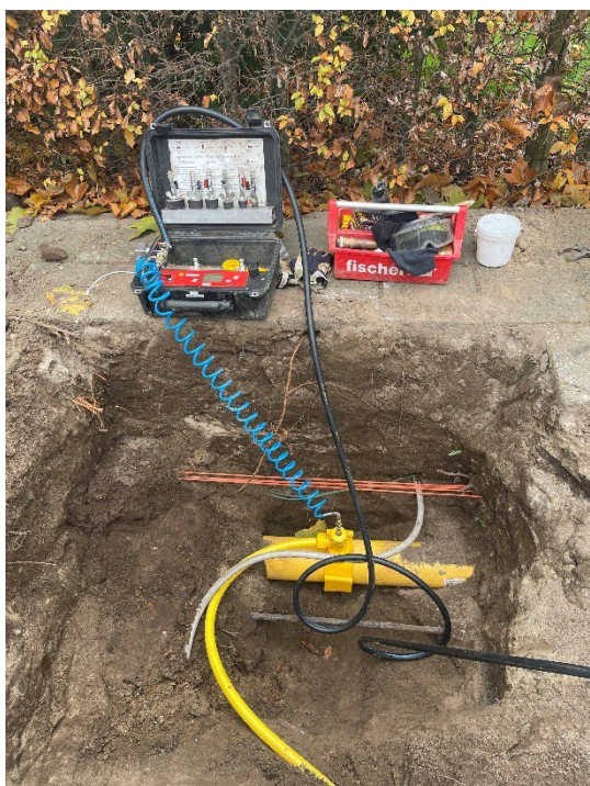
Inertisering met N 2 van aftakzadel op H 2 hoofdleiding t/m aansluitkraan verbruikstoestel.
