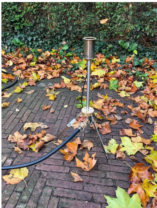
Uiteinde spoelslang verbonden met minifakkel installatie.
