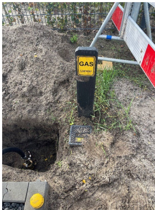
Detailfoto aansluitpunt fakkelinstallatie op blaasgatzadel BG-001.
