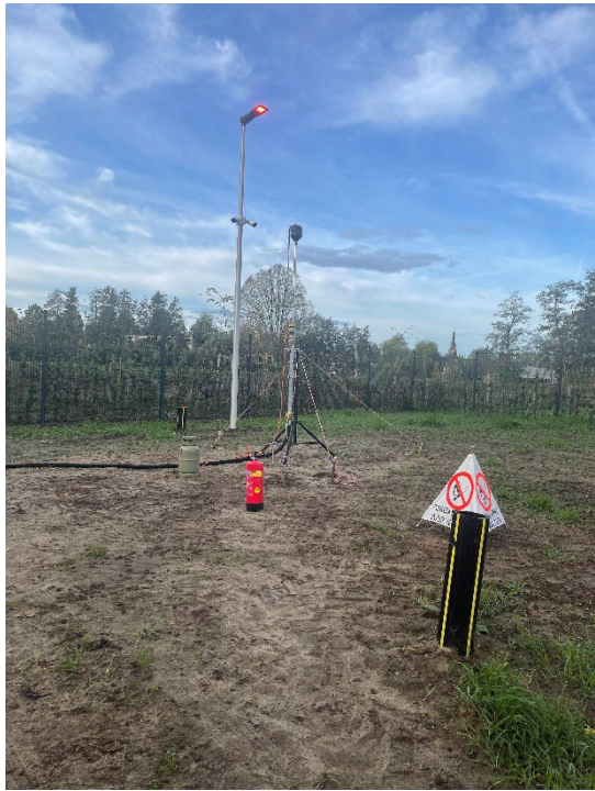
Mobiele fakkelinstallatie in bedrijf.
