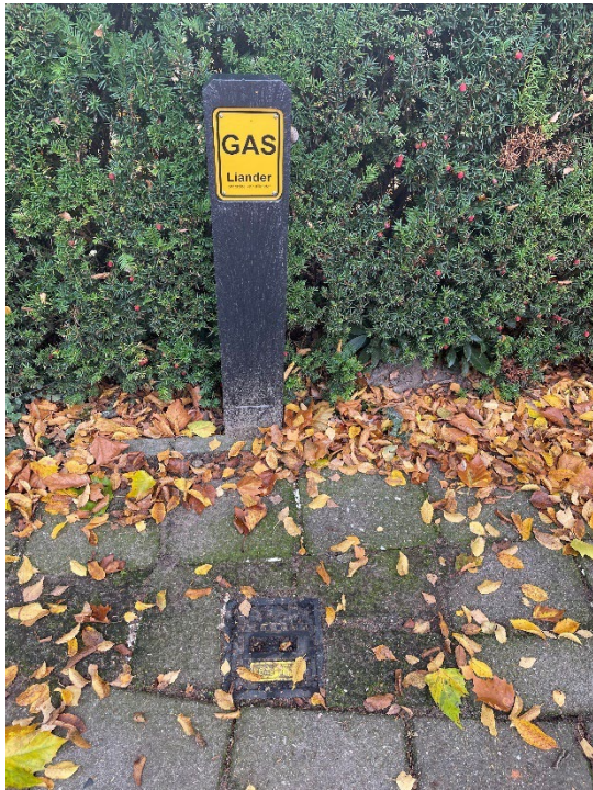
Aanduidingsbord & straatpot gasafsluiter.
