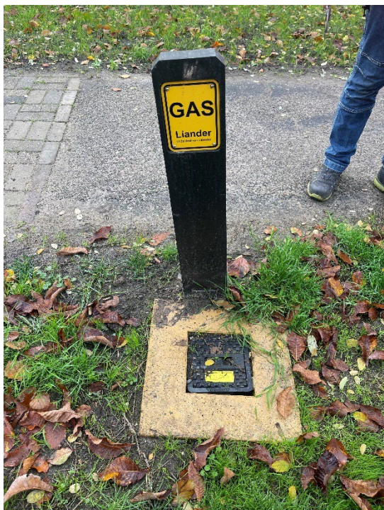
Aanduidingsbord & straatpot gasafsluiter.
