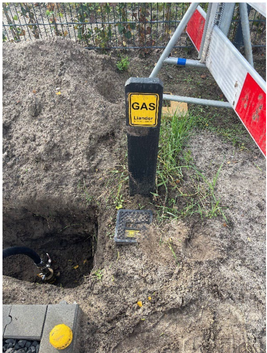
Aanduidingsbord & straatpot gasafsluiter.
