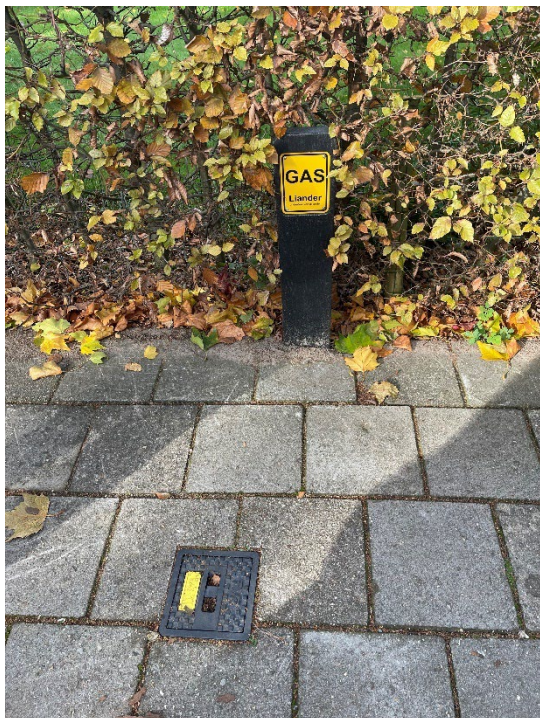
Aanduidingsbord & straatpot gasafsluiter.
