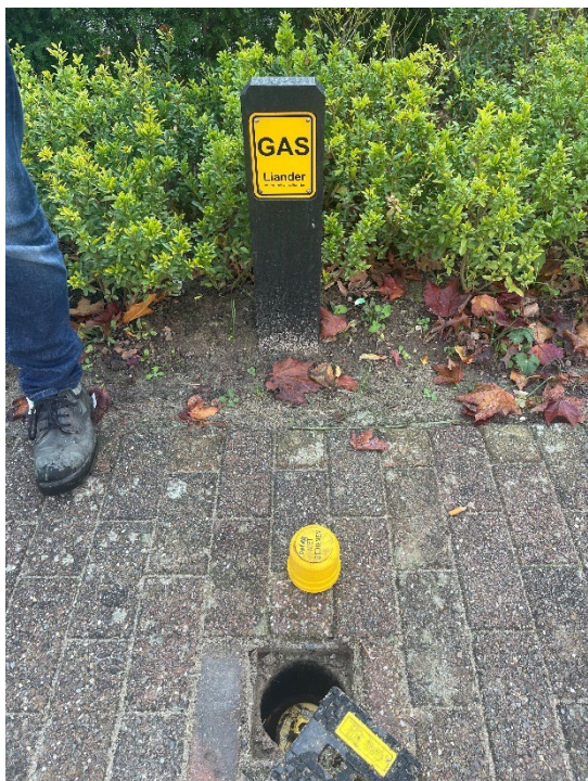
Aanduidingsbord & straatpot gasafsluiter.
