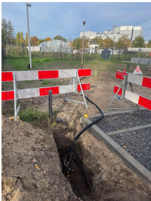
Connectie flexibele slang op de koppelleiding (is leidingdeel tussen invoedstation en hoofdleiding) naar fakkelinstallatie.
