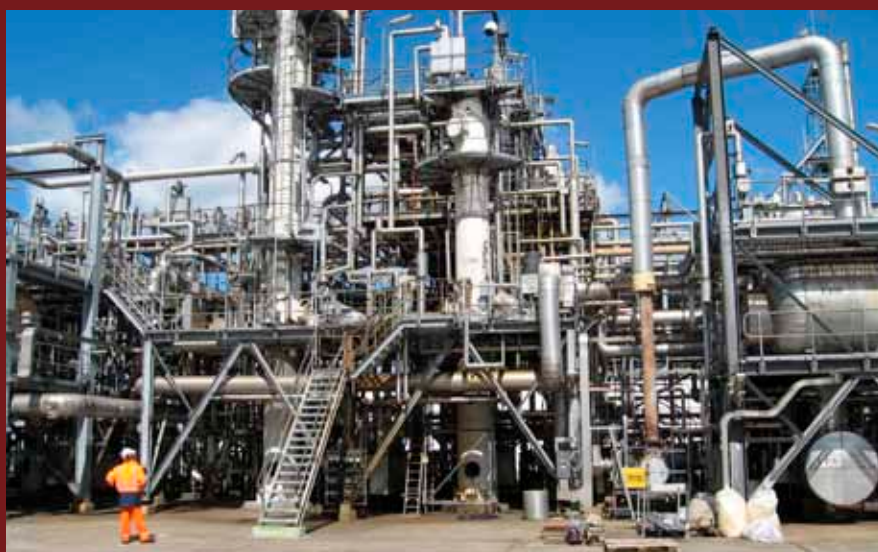
Overzicht van de Shell Claus Offgas Treatment Unit (SCOT-unit)
