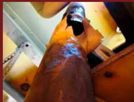
Gescheurde ventleiding door externe corrosie (foto SodM)
