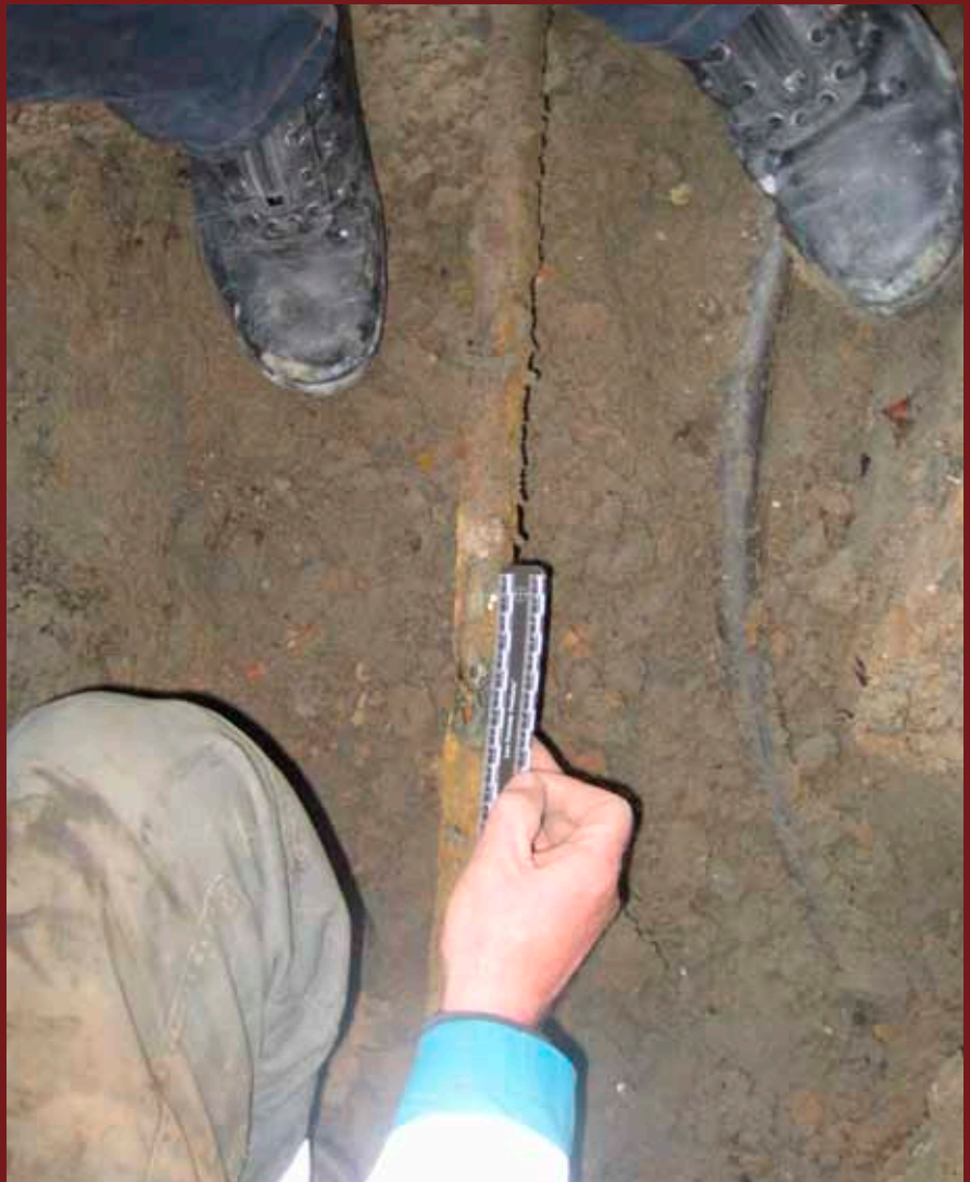
Georrodeerde aansluitleiding in de wijk 't Duifje in Arnhem (foto SodM)
