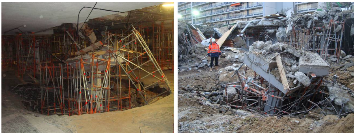
Figuur 7: Sinkhole in de parkeergarage van winkelcentrum 't Loon te Heerlen (2011). Foto rechts ten tijde van de sloop van een deel van het gebouw.
