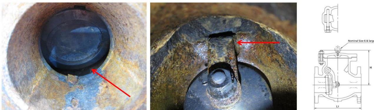
Foto's van de binnenzijde van de terugslagklep, die in geopende stand vast zat (rechts een schema van de werking)
