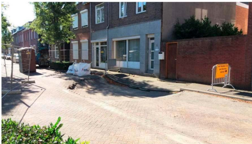
Figuur 18 Verzakking bij een oude schacht, DOM 37 in Kerkrade op 23 juli 2020 (Bron ingenieursbureau IHS).
