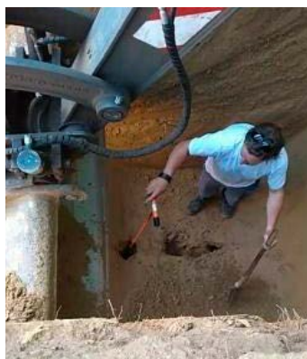
Figuur 48 Na het optreden van spoelingsverlies bij boren in een drempel is deze uitgegraven. Een grote open sleuf bleek aanwezig op een paar meter diepte (foto: Jaap Spaans, Informatiecentrum).
