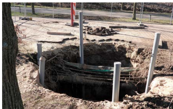
Figuur 35 Ontwikkeling van een sinkhole na ruim een week met blootlegging van leidingen.
